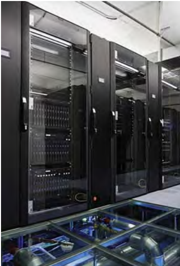
Im wirtschaftlichen Rechenzentrum werden alle Verbraucher effizient optimiert.
