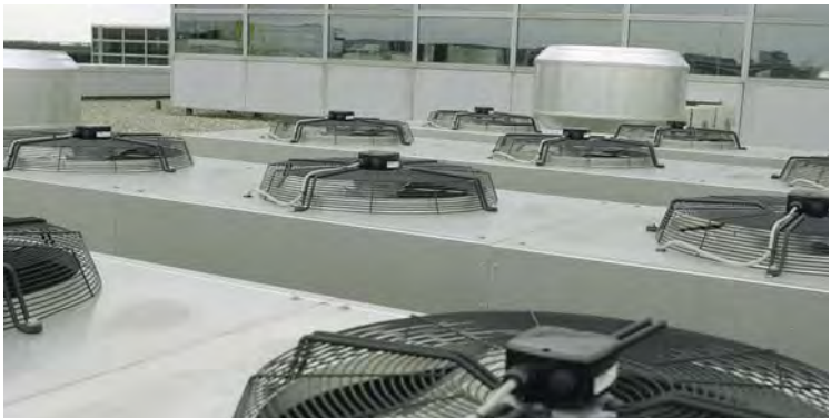
Energieschonende Freikühlung lässt sich vielfach nutzen.
