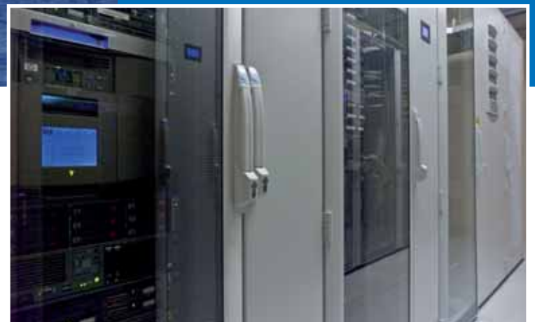
RimatriX5 opstelling in de nieuwe IT-ruimte van Huisman Equipment B.V.
