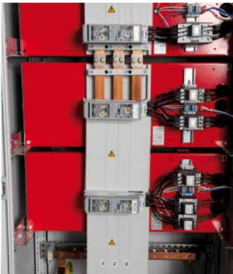
Verteilsammelschiene: berührungssicher durch RiLine
