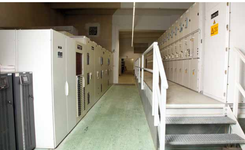
In der Schaltanlage gibt es zwei Mittelspannungssysteme mit 6 kV und darunter gelagert 31 Verteiltransformatoren, die die Energie von 6 kV auf 400 V umwandeln.
