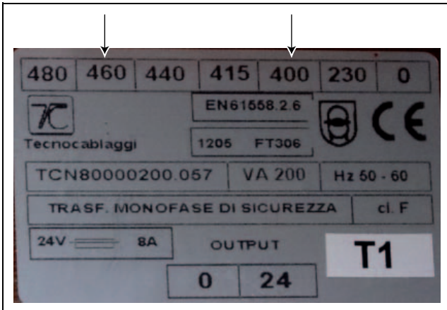
Fig. 21 : raccordement du transformateur
