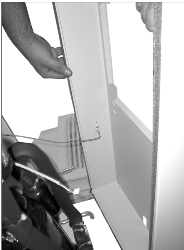
Рис. 72: Кожух корпуса и корпус кондиционера соединены кабелем заземления
