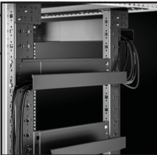
Canal para cables para VX IT
