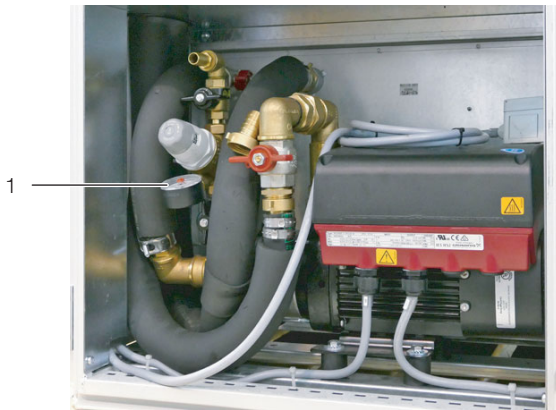
Abb. 44: Manometer im Wasserkreislauf
