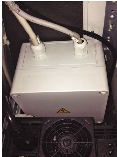
Abb. 57: Zusätzliche Box für die Thermosicherungen der elektrischen Heizer
