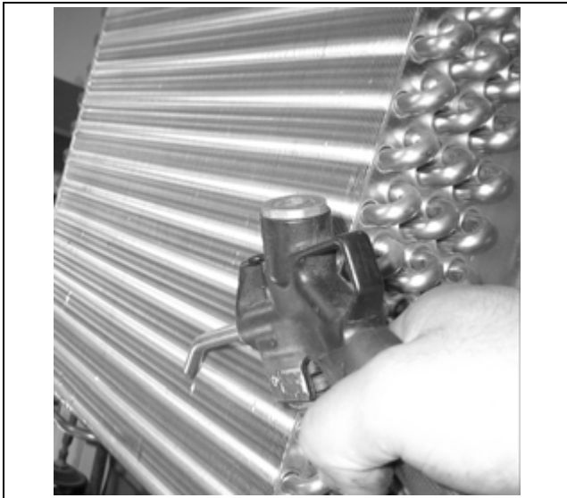
Fig. 47: Pulizia del condensatore
