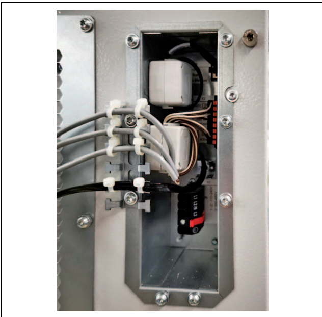
Abb. 33: Montagepunkt der Ferritkerne bei SK 3186330, SK 3187330, SK 3188340, SK 3189340
